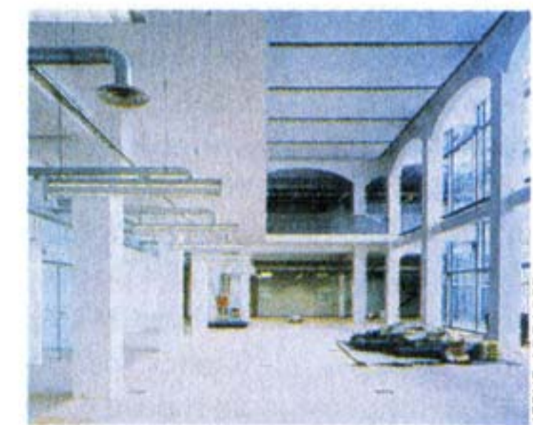
Il a fallu un an de travaux pour aménager le bâtiment désaffecté.
